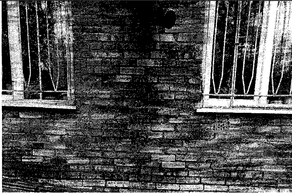
Фото 14. Наружная стена. Многочисленные участки замачивания и разрушения отделочного покрытия стен атмосферными стоками с кровли.
