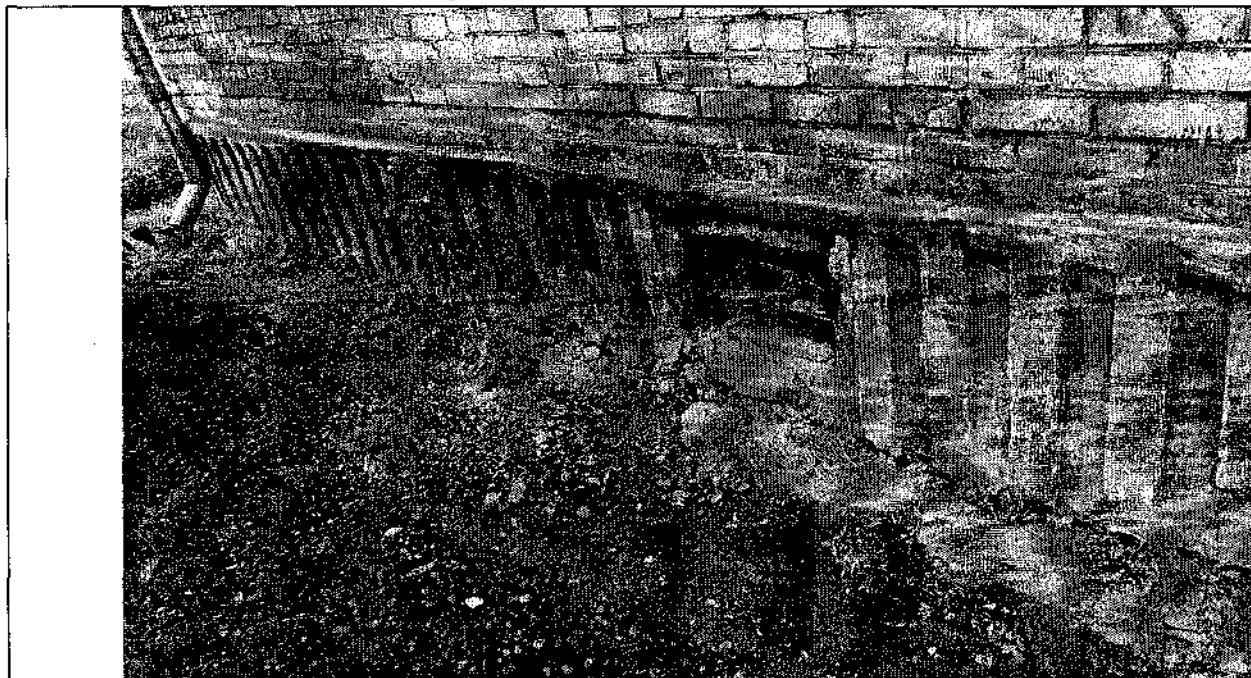
Фото 1. Отмостка здания. На локальных наличие разрушений и отхождение отмостки от стен здания.
