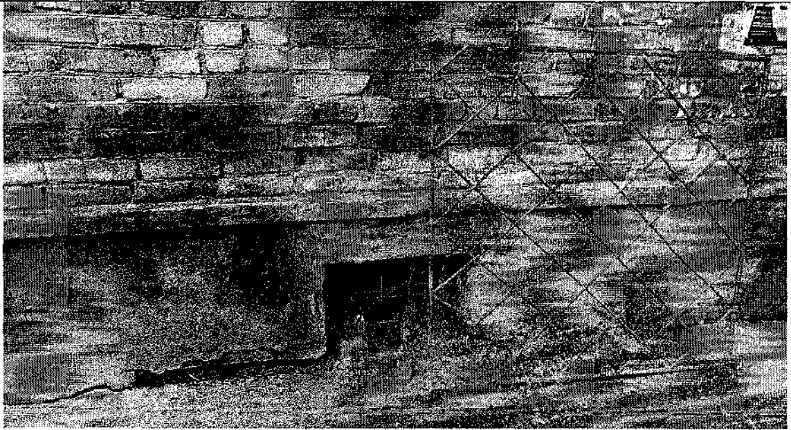
Фото 2. Отмостка здания. На локальных наличие разрушений и отхождение отмостки от стен здания разрушений и отслоений штукатурного слоя от кирпичной кладки стен подвала.
